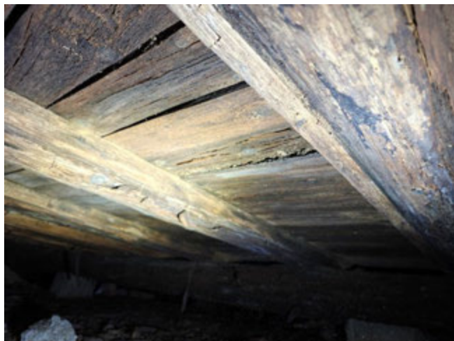
Kuva 6. Lahoja ja mikrobikasvua alapohjassa.
